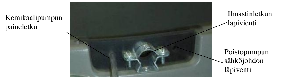
Kuva 14. Kompressorin ilmastinletkun läpivienti laitesuojasta prosessisäiliöön.
